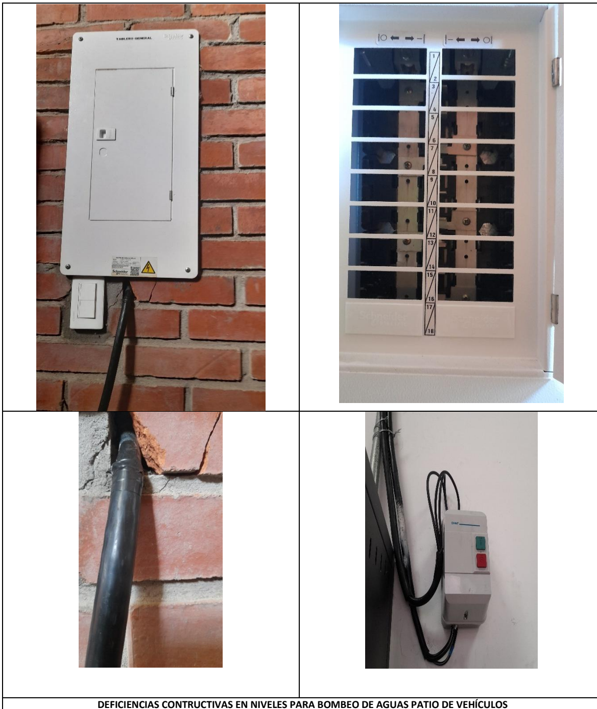
DEFICIENCIAS CONSTRUCTIVAS EN NIVELES PARA BOMBEO DE AGUAS PATIO DE VEHÍCULOS
